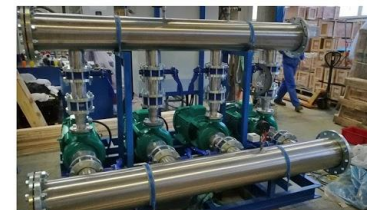
Водоканал г. Муром
